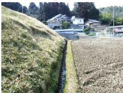
はらみだし及び陥没
