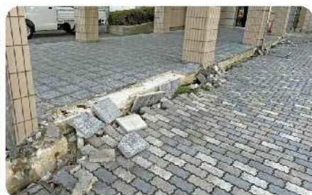
志賀町役場の被災状況(11月時点)
