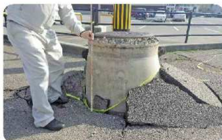
液状化によるマンホールの浮上の状況
