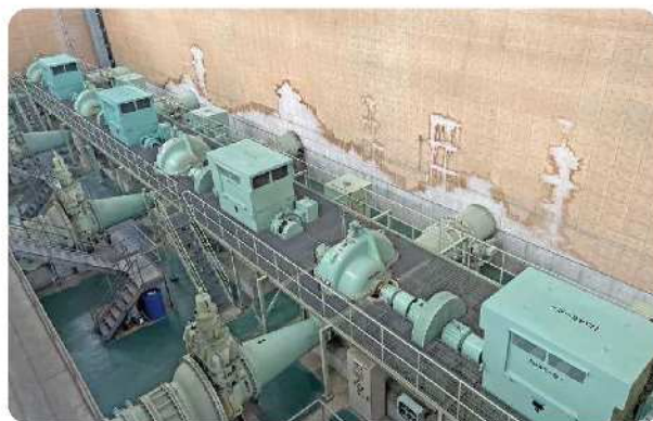
両総用水第2揚水機場
