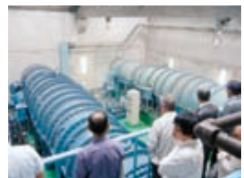
十二町瀉排水機場
