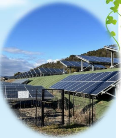
芥見大船太陽光発電所は各務用水の中流域に位置しています。この発電所によって使用電力の約85~90%を自給しています。
