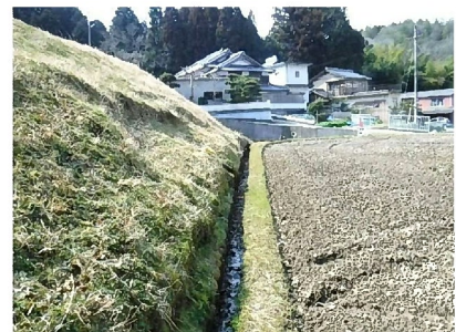
はらみだし及び陥没
